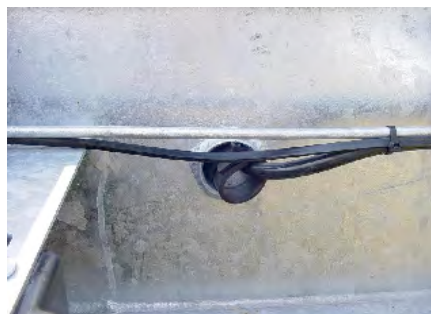
Doorvoeren in chassis afgeschermd met rubber mantel.
